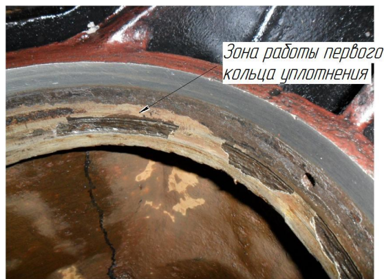
Рис. 2. Вид износа со следами пасты холодного ремонта
