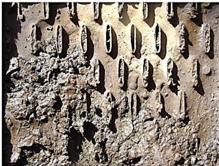
Рисунок 6 – Состояние системы водоохлаждения дизеля тепловоза
