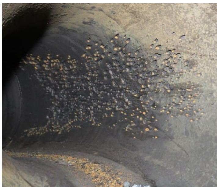
Рисунок 3 – Кавитационное разрушение трубопровода
