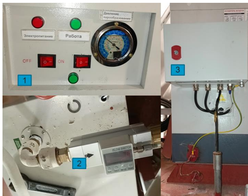
Рисунок 2 – Внешний вид установленного оборудования:
