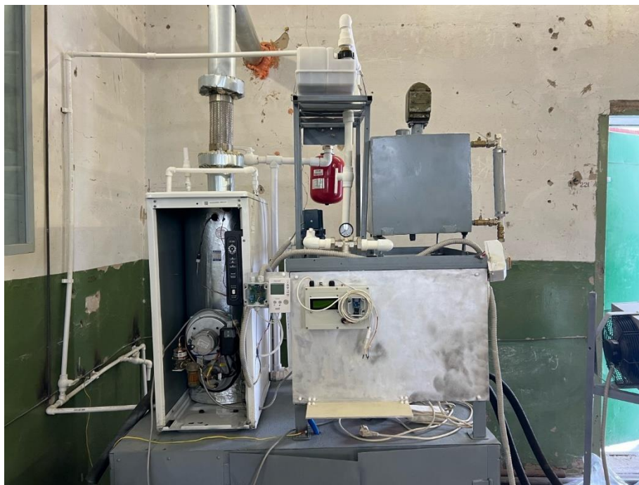
Рисунок 1 – Общий вид стенда с судовым водогрейным котлом Kiturami TURBO-17
